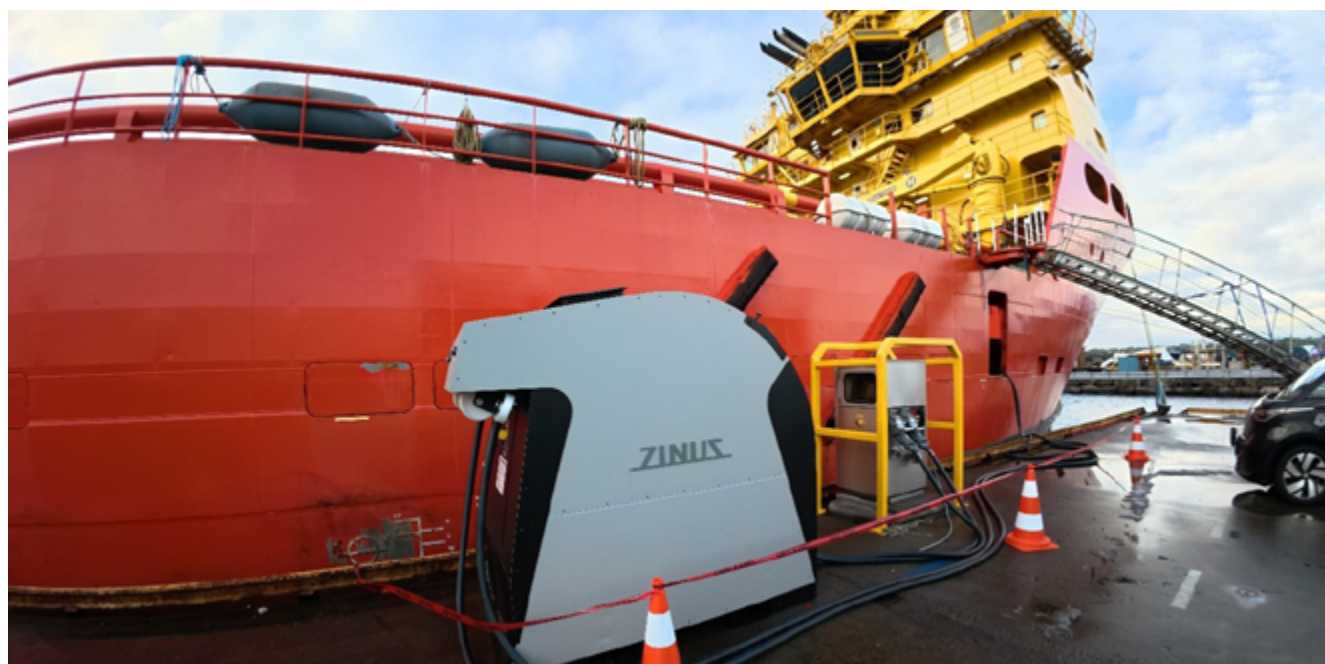
Det nye landstrømanlegget på Killingøy gir full dekning på alle kaier og ble tatt i bruk for første gang 11. desember 2025. Foto: Havnekraft
