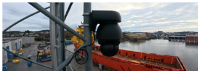
Havnekraft har etablert egen overvåkning av landstrømanleggene for å sikre stabil drift og bedre oppfølging av anleggene i havnene. Foto: Havnekraft
