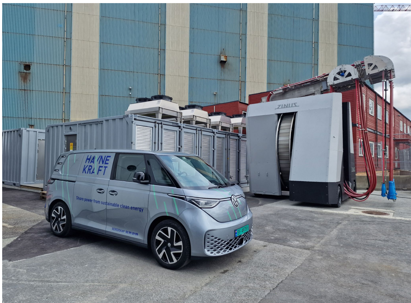
Landstrømanlegget på Garpeskjær kan dekke behovet til alle cruiseskip som anløper Haugesund Cruise Port. Foto: Havne Kraft
