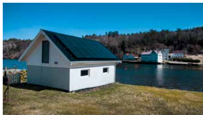
Ferdig montert solcelleanlegg til pilotkunde.
